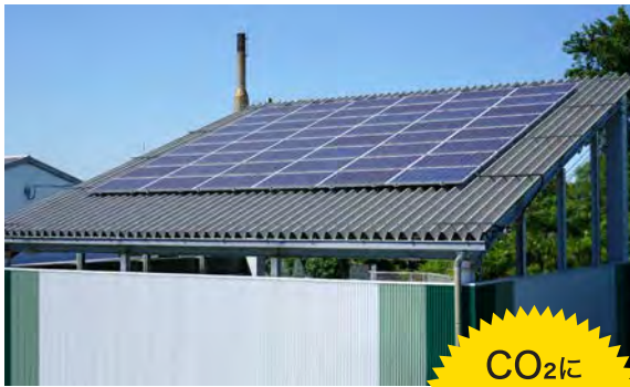
社内設置太陽光パネル
